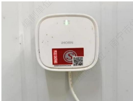
燃气泄漏报警装置
