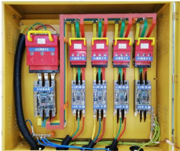
分配电箱实物图
