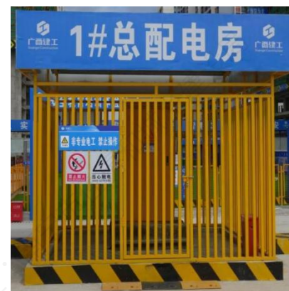
电气设备防护二
