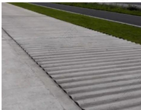
振筛作用的工地出入口搓板道路
