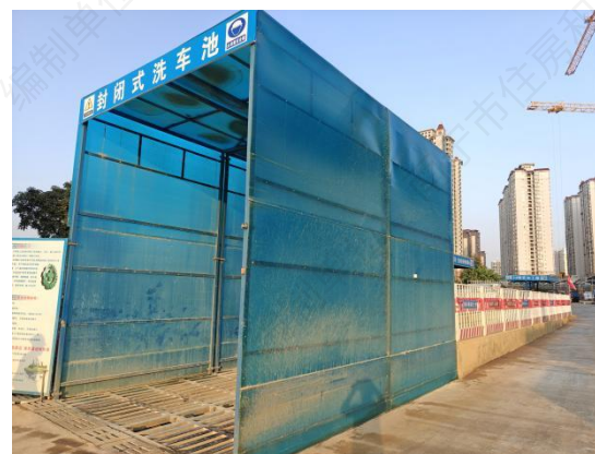
封闭式洗车池
