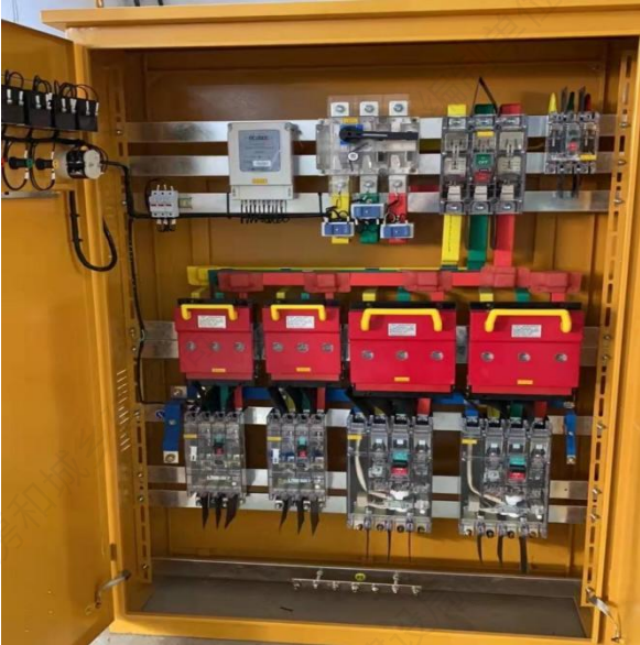
总配电箱实物图
