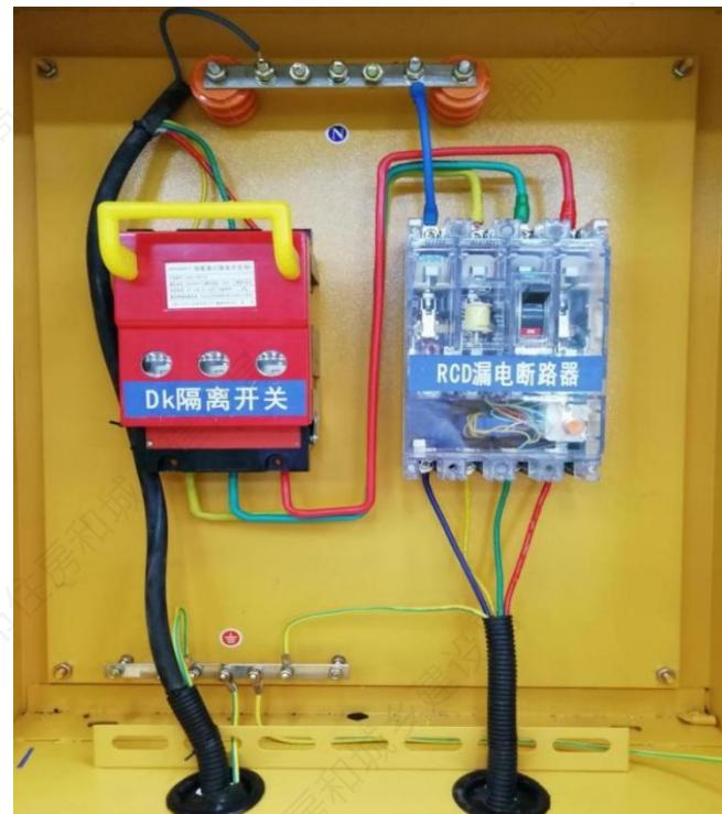
开关箱实物图
