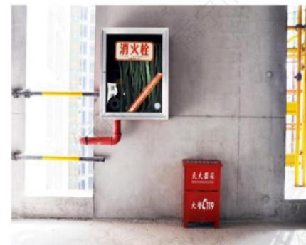
楼层层层布置消火栓
