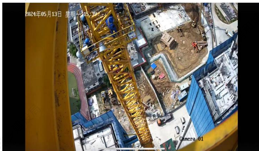
塔吊视频监控示例
