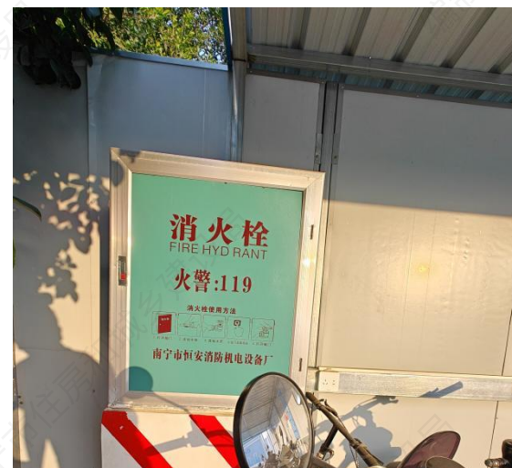
电动车充电棚消防设施
