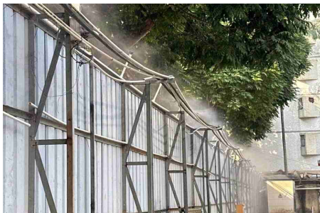
围挡喷淋系统
